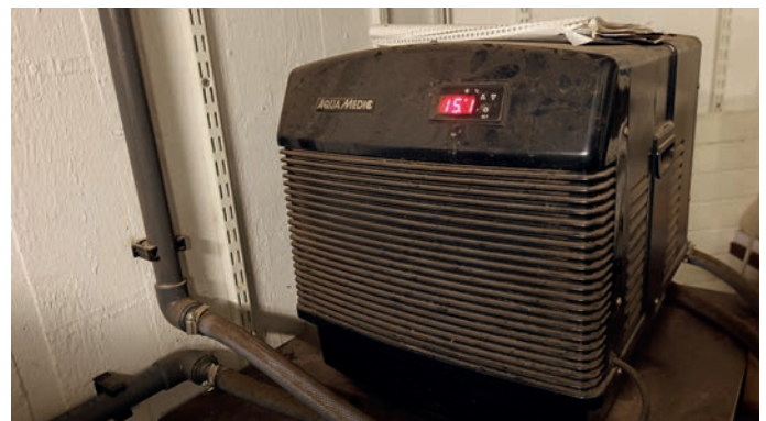
Kühlgerät zum Einstellen der erforderlichen niedrigen Wassertemperatur | Sebastian Rohling
