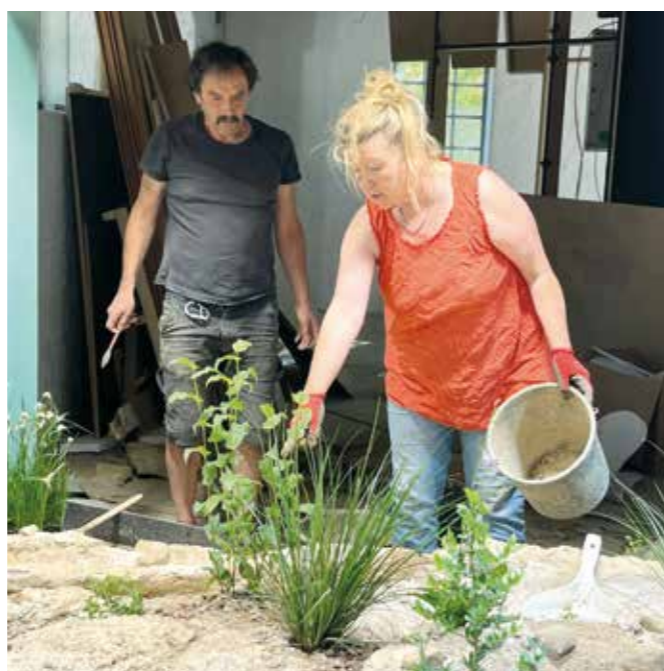
Baustellen-Pingpong. Während Sabine Hohmann mit der Bepflanzung der Unkenanlage beginnt, optimiert Oliver Blomeier noch den Wasserlauf.
